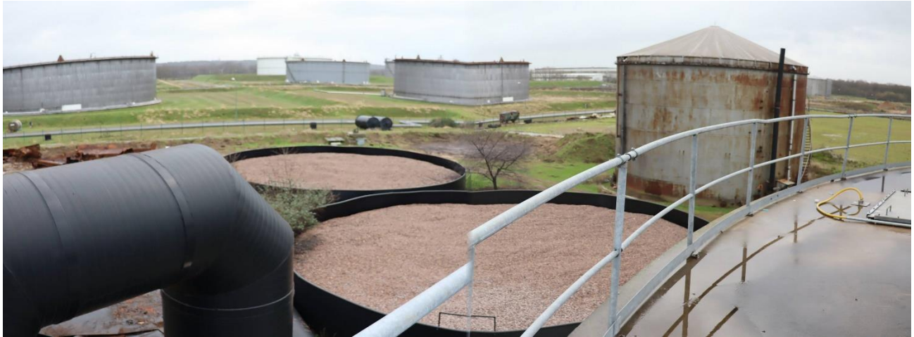
Blick in Richtung Südost: bestehende Biofilteranlage (der hintere Filter wird zurück gebaut und dafür die Wäscheranlage wieder in Betrieb genommen)
