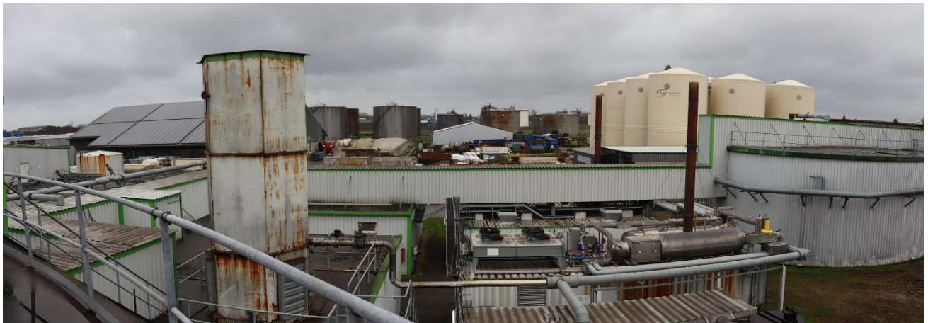
Anmischbereich und vorhandenen BHKW-Anlage, im Hintergrund: nördlich gelegener Nachbarbetrieb
