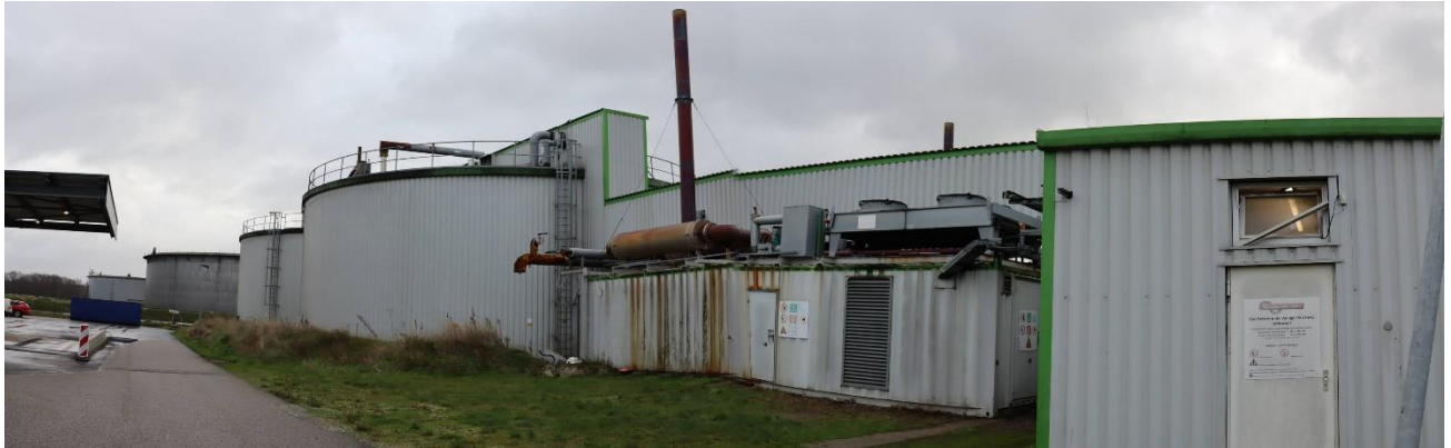
Anmischbereich und vorhandene BHKW-Anlage
