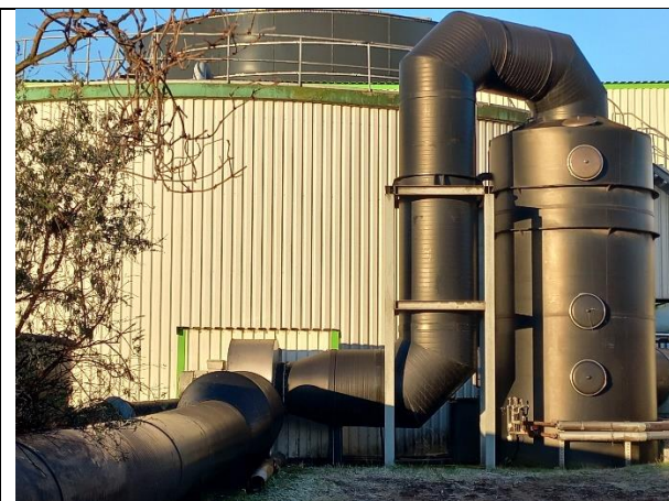
Abb.: Abluftwäscher DN200
