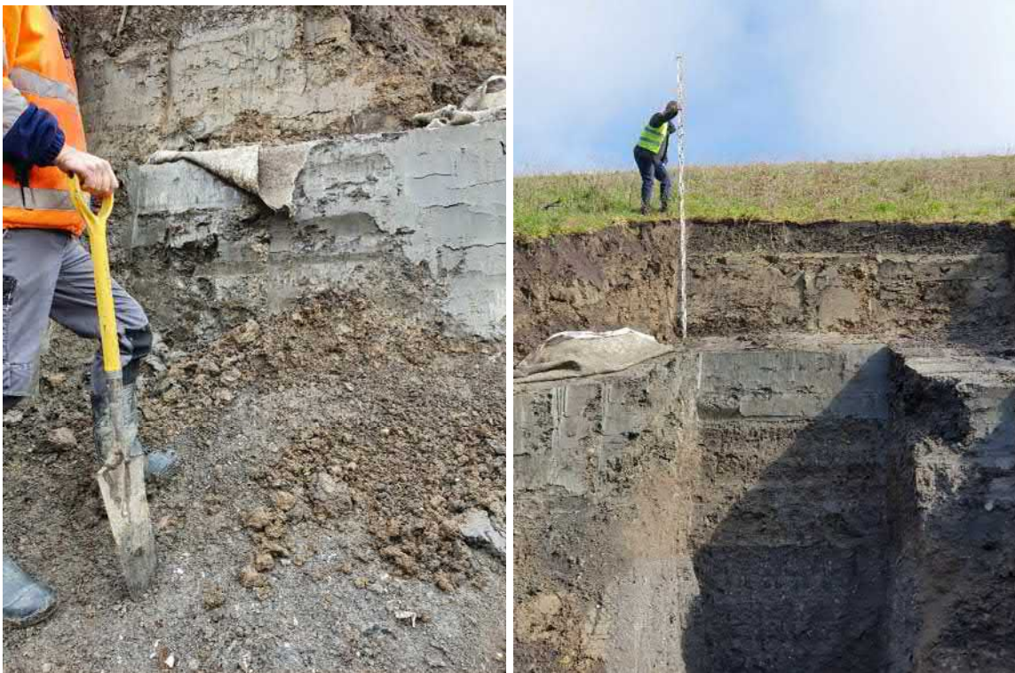
Abb. 4: Oberflächenabdichtung (min. Dichtung) über Trag- bzw. Ausgleichsschicht (braun-grau), darüber Drainmatte und Reku-Schicht
