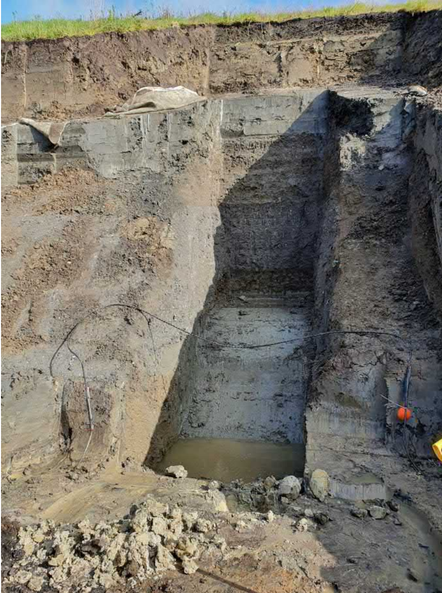
Abb. 2: Schurf 5 (Blick nach Norden) am 07.05.2021 morgens nach starken Regenfällen; das Niederschlagswasser staut sich in dem Schurf innerhalb des Geschiebelehms
