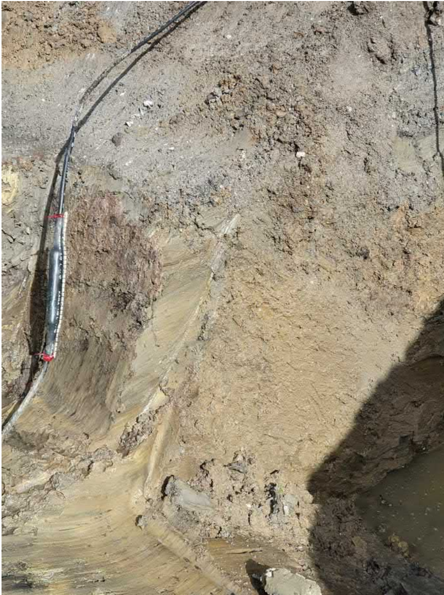
Abb. 6: Detail Übergangsbereich Geschiebelehm / Oberflächenabdichtung mit der ausgebessertem Telefonleitung
